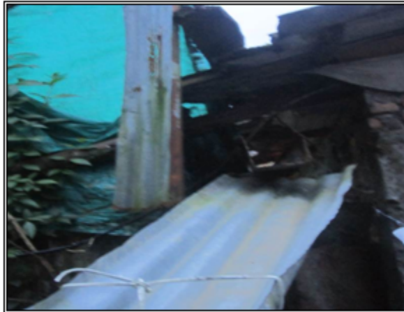
Figura 6. Canaletas en zinc para conducir el agua en las viviendas
