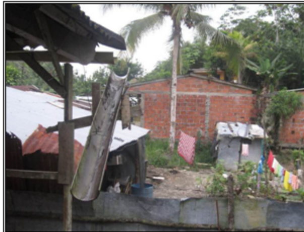
Figura 7. Canaletas en asbesto para conducir el agua en las viviendas
